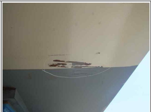
내 용 거더 외부 도장긁힘 및 부식(S4-G1)
