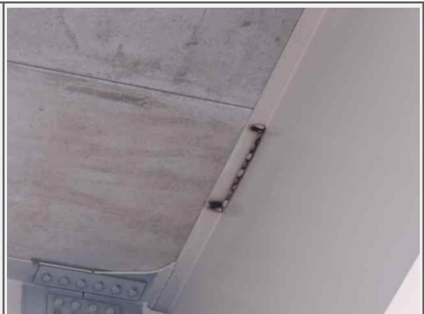
내 용 거더 외부 용접열에 의한 도장박락(S1-G1)
