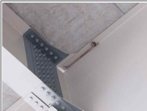
내 용 거더 외부 용접열에 의한 도장박락(S1-G2)
